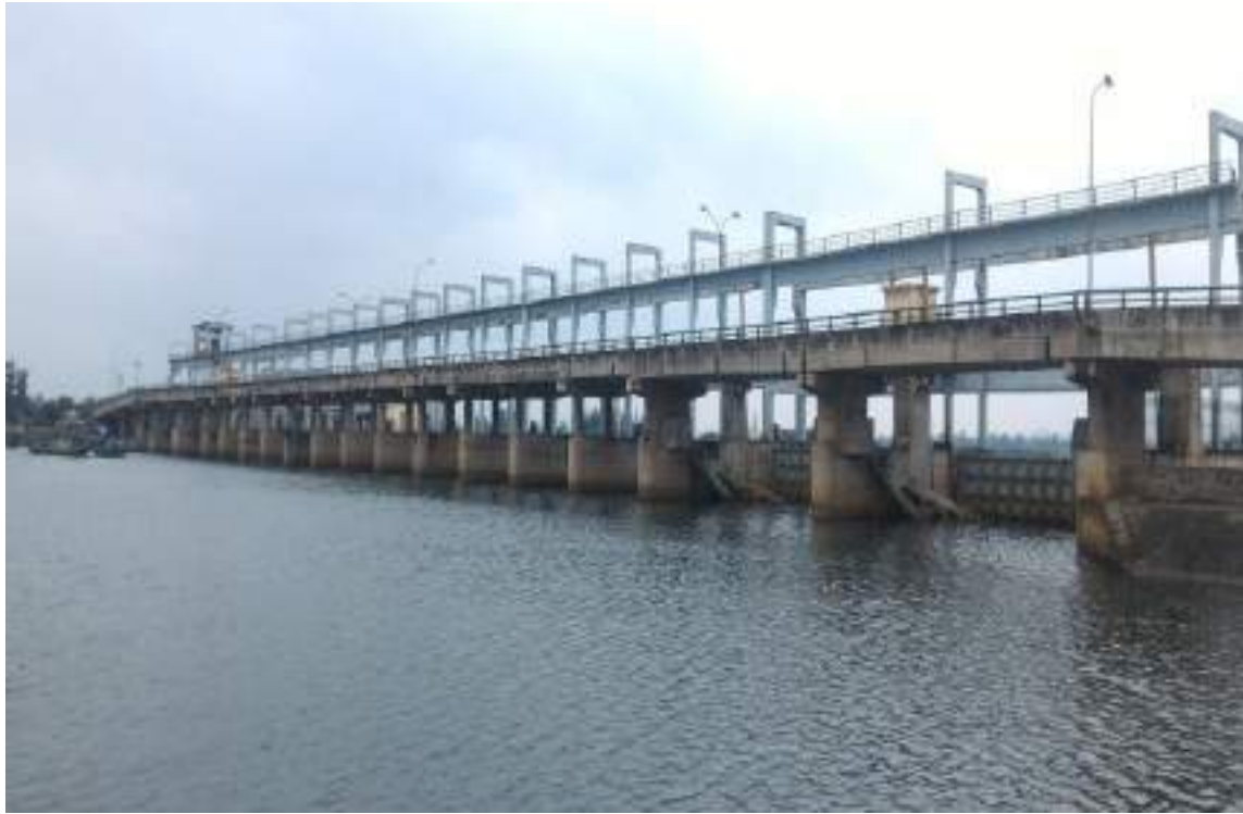
Photo 0.9: Do Diem saltwater barrier on the Nghen River (đập ngăn mặn Đệ Nhất ở xã Đệ Nhất, huyện Nghi Xuân, tỉnh Hà Tĩnh)
